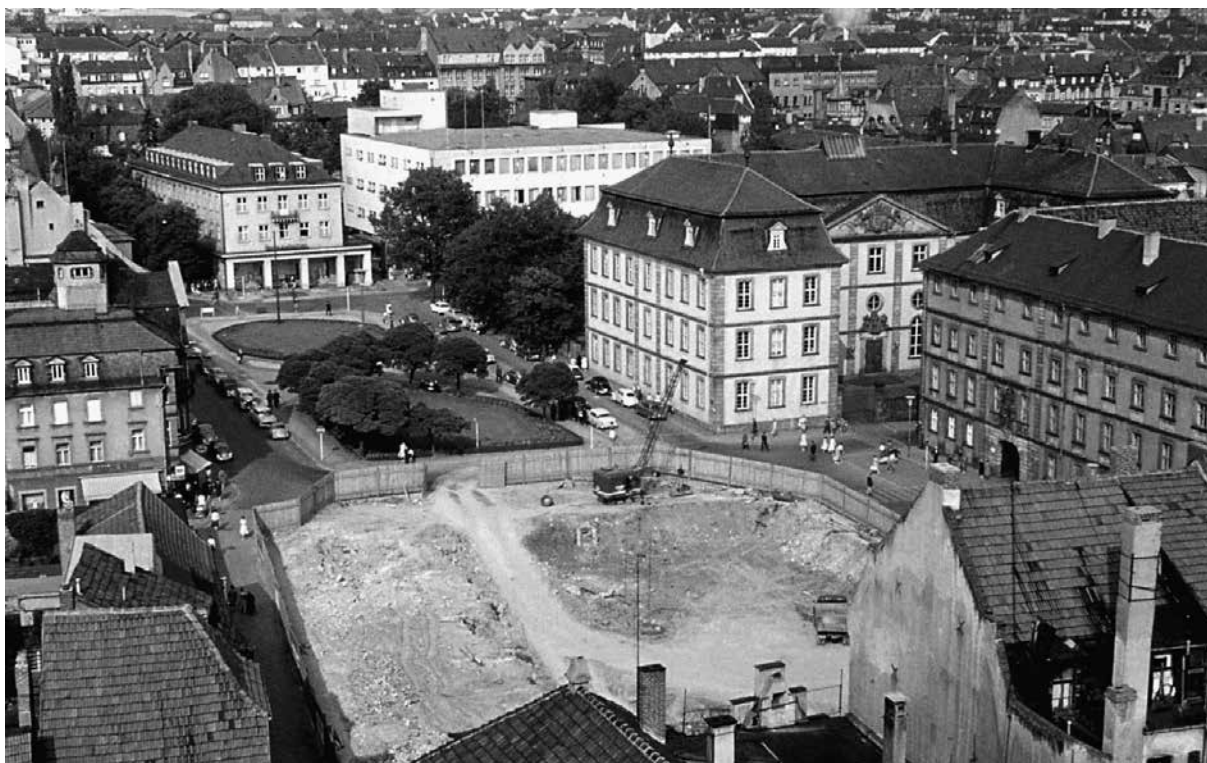
Abb. 13: Universitätsplatz, Juni 1961 (Fotografie, StA Fulda, Inv. Nr. BA-34.776). Der gleiche Blick ging im Juni 1961 über die große Baugrube des vollständig geräumten Borgiasgeländes, auf dem bis 1964 das Kaufhaus Karstadt errichtet wurde. Am linken Bildrand steht noch die nördlich Zeile der Borgiasstraße, die kurz darauf ebenfalls abgerissen wurde.
